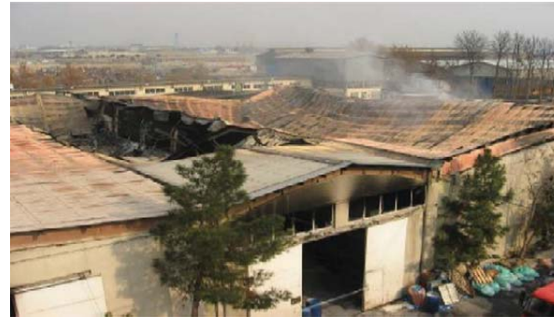
شکل ۲: نابودی سوله‌های تولید و انبار در کارخانه داروگر
