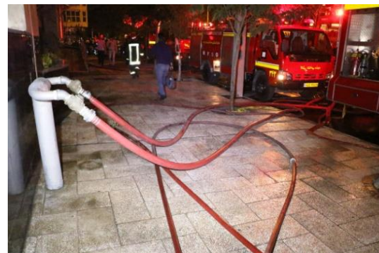
شکل (۱۱): عملکرد مناسب سیستم لوله خشک آتش نشانی
