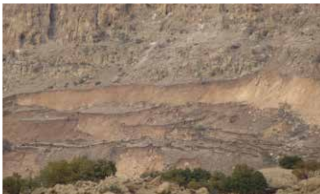
شکل ۶. نمایی از افت گاه اصلی لغزش. دید به سمت شمال شرق
