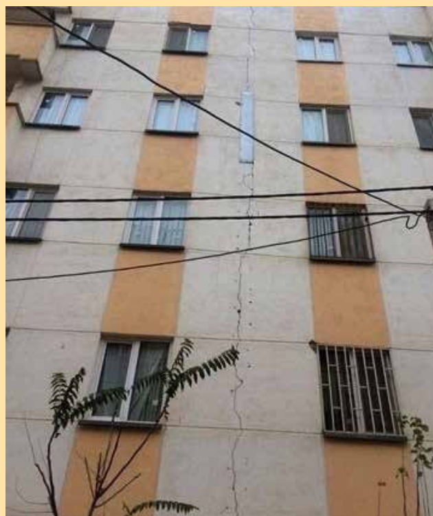
شکل ۲- ترک خوردگی نمای خارجی ساختمان(از گزارش سازمان زمین شناسی، سلیمانی و همکاران ۱۳۹۶)
