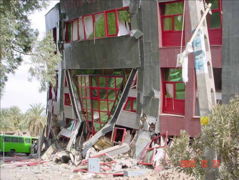
شکل ۴. تغییر مکان قائم شدید و تخریب طبقه اول یک مجتمع در شهر بم
