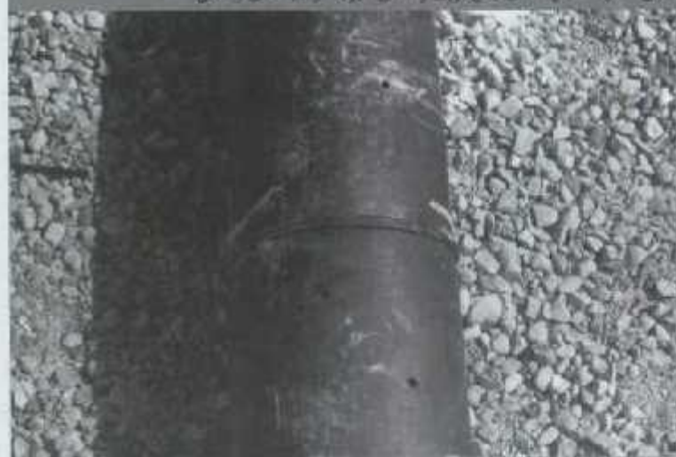
شکل شماره ۳: لوله های جمع آوری و انتقال شیرابه در لایه های زهکش
