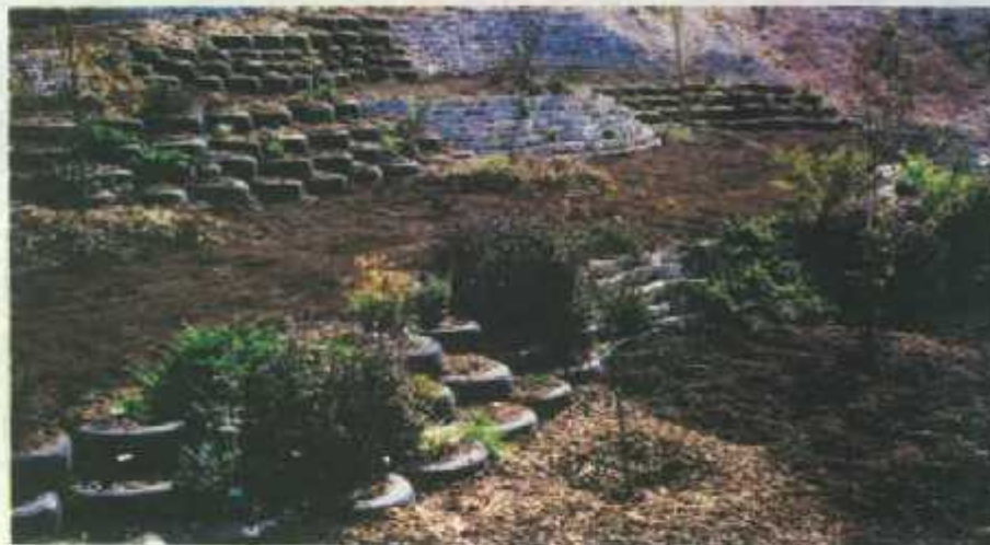
در این تصویر، حدود ۲۵۰ متر از ساحل در حال ریزش به ارتفاع ۱ متر در امتداد دیوار کروی که منطبق بر منحنی ساحل با ۲۴ هزار لاستیک به یکدیگر بسته شده، تثبیت شده است. کاپله به یک نگهدارنده (یک لاستیک در انکوری) که در فاصله مشخصی در بالای ساحل دفن شده است اتصال یافته است.
