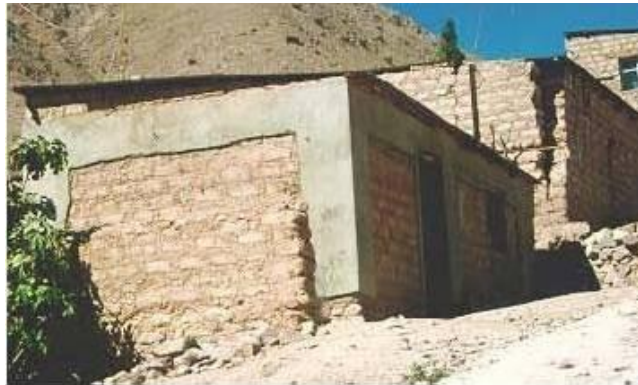
شکل پ-۲-۲۱- ساختمان جلو به دلیل داشتن کلاف آسب ندیده ولی ساختمان بدون کلاف آسب دیده است.
