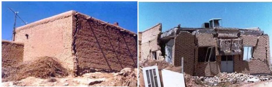
جداشدن دیوارها و نریختن سقف سبک چوبی (زلزله قائن ۱۳۸۴)
