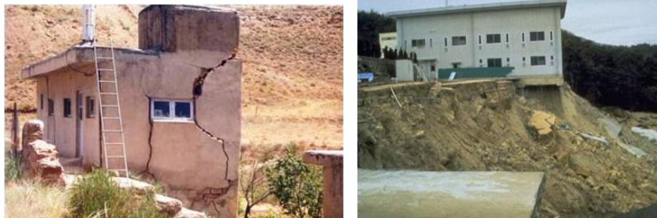
شکل پ-۲-۶- انتخاب ساختگاه نامناسب و اجرای غلط ساختمان بر روی سطح شیبدار
